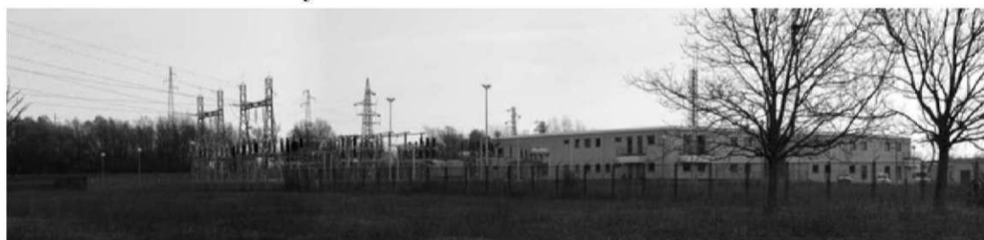
Slika 30 Trafostanica TS 110/10(20) kV Siscia
