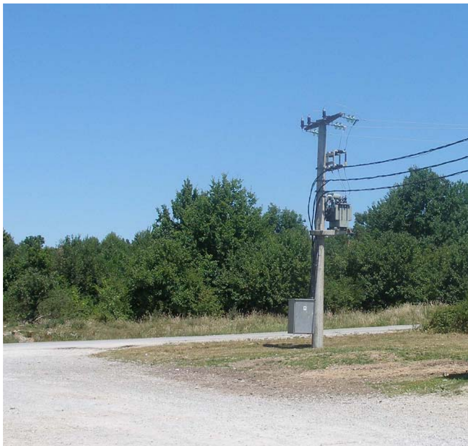
POSTOJEĆA STUPNA TRAFOSTANICA NA ULAZU U PROGNAIČKO NASELJE
