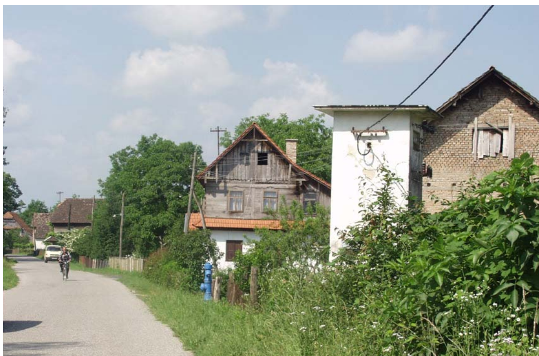
Slika 57. Trafostanica u naselju Suvoj
