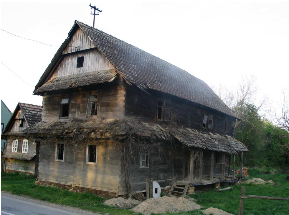
Sl. 32. Propadanje drvenih stambenih objekata
