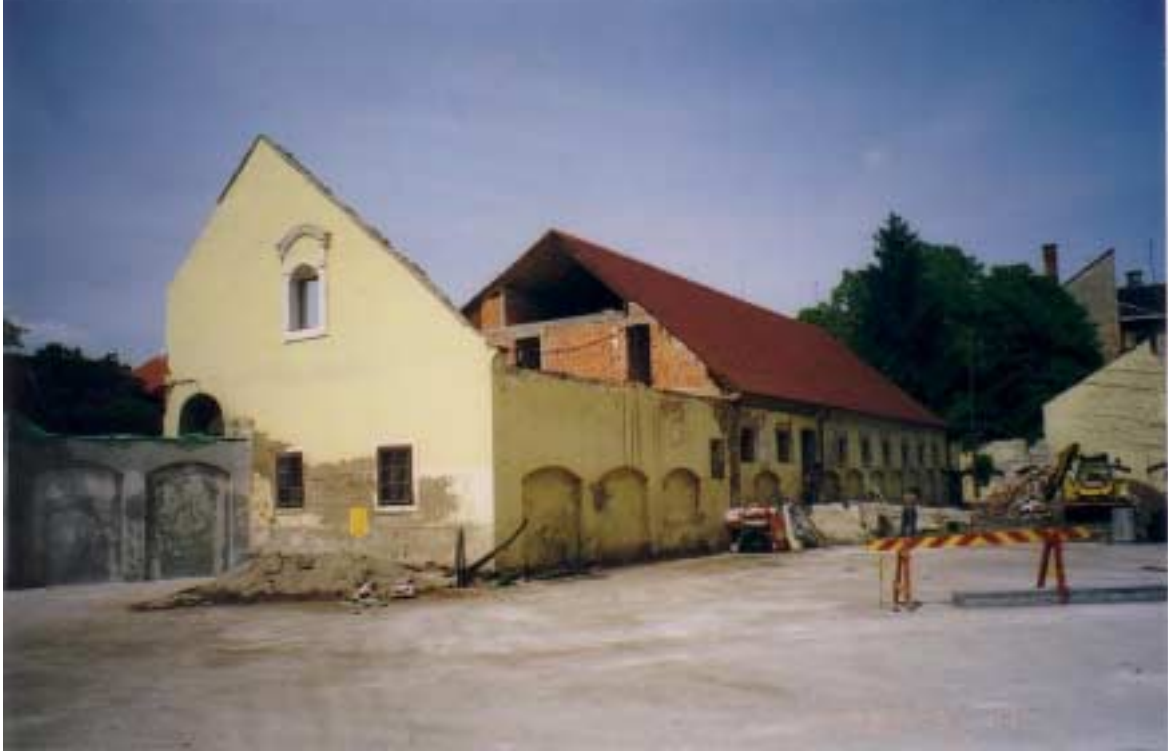
radovi na obnovi zgrade iza župnog dvora na Trgu bana J. Jelačića
