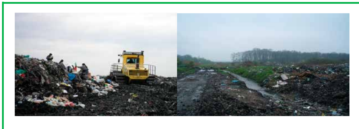
Slika 3.: Stanje prije sanacije
