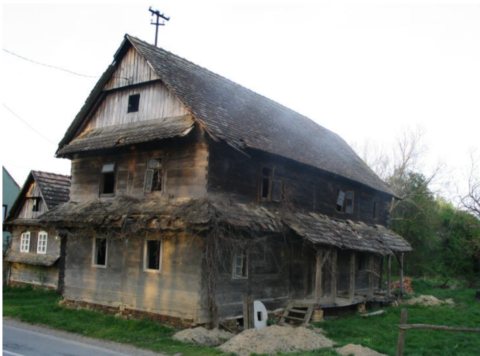
Sl. 32. Propadanje drvenih stambenih objekata
